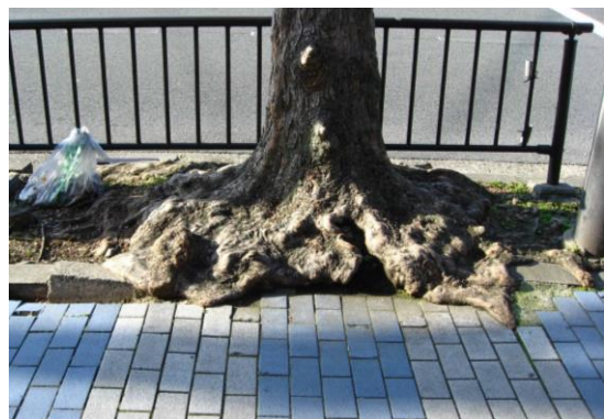
根元のおふれ出し・縁石の持ち上げ・ずれ
