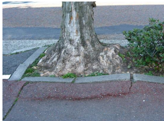
歩道舗装・縁石の持ち上げ・ずれ・ひび割れ
