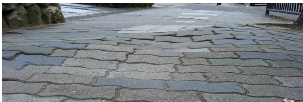
写真 2-1 歩道舗装の持ち上げによる隆起の例
