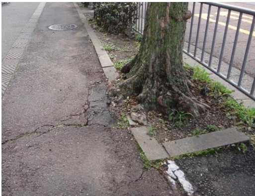
歩道舗装のひび割れ・根元のおふれ出し
